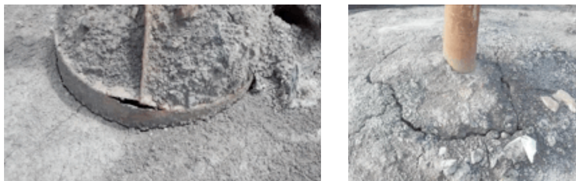
Figura 8 a e b – Fuga pelo biogás pelo dreno danificado e trincas no solo
